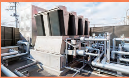
空冷式ヒートポンプチャラーと貯湯槽
