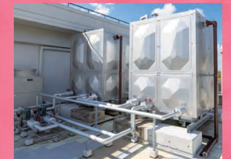
循環加温式ヒートポンプチャラーの貯湯タンク
