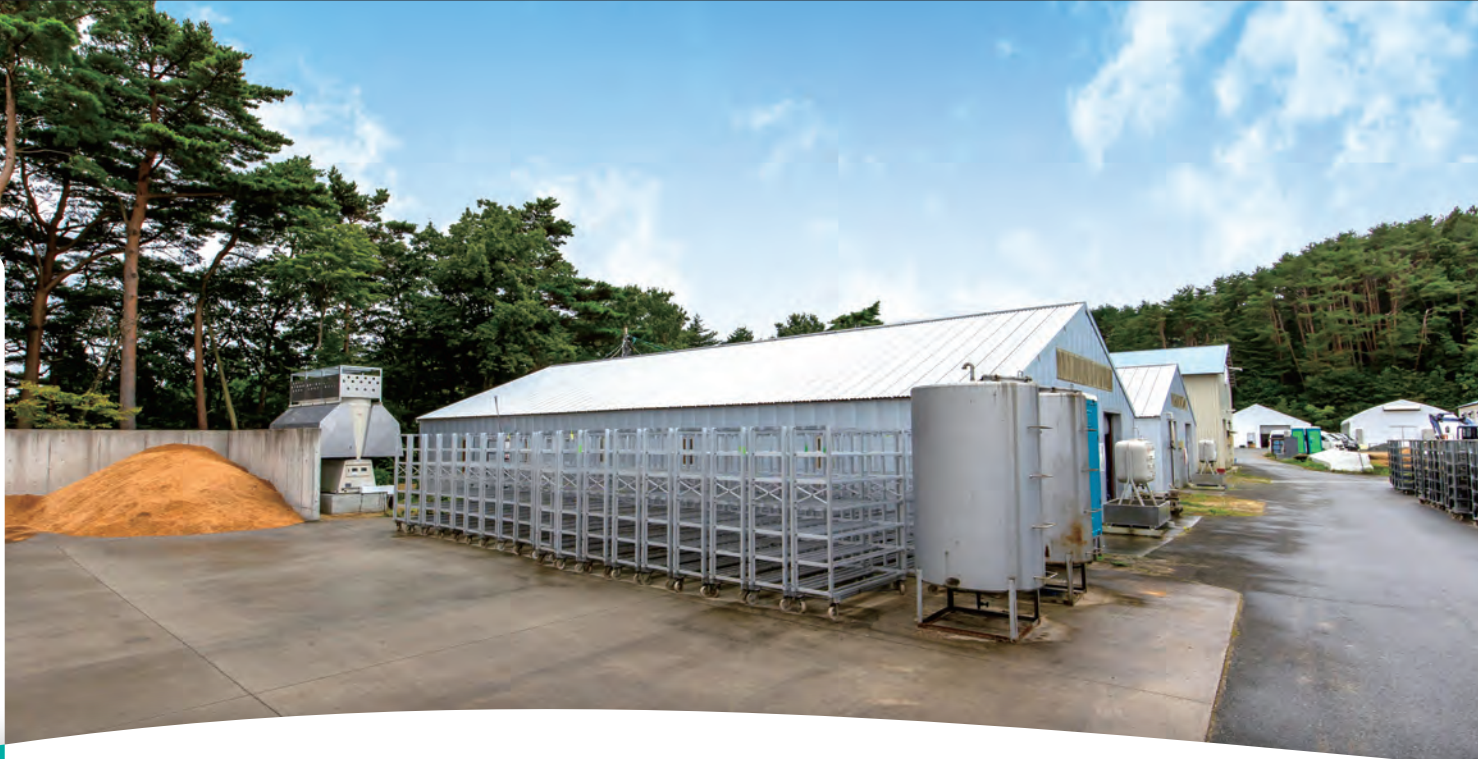
空冷式ヒートポンプチラー(左)と大型ハウス
