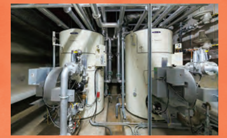
施設内に設置された温水ボイラ(ガス)
