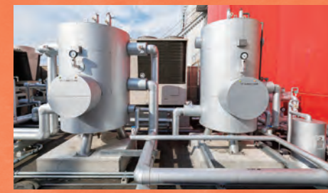
熱源タンクと循環加温ヒートポンプ(後方)
