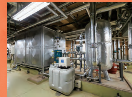
貯湯槽と温水タンク
