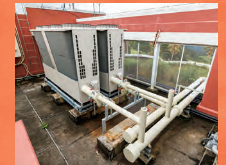
ホテル屋上に設置された空冷式ヒートポンプチラー
