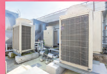
北館屋上に設置された循環加温式ヒートポンプチャラー(手前)と業務用ヒートポンプチャラー(奥2台)
